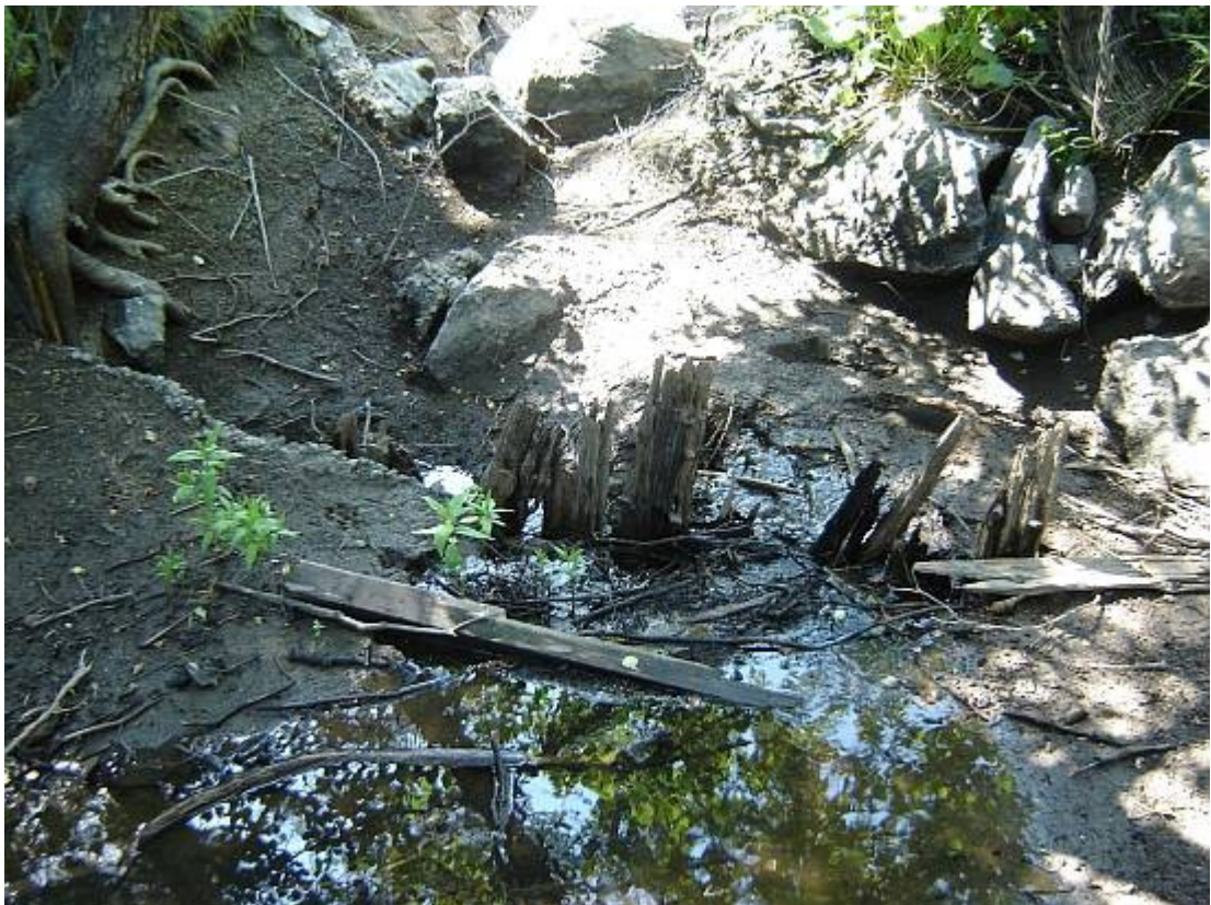
Här sipprar vattnet in under vägen 13.7.2005
